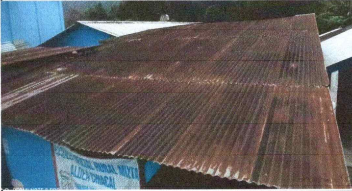
Cubierta de laminas instalada desde el año de 1988, por los años que lleva de uso ya se deterioraron.
