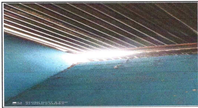
Las laminas ya no estan seguras por la madaera deteriorada.
