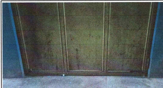
Puertas deterioradas, a pesar de que son de metal, ya estan muy deterioradas
