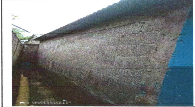
Paredes que necesitan repello en su totalidad.
